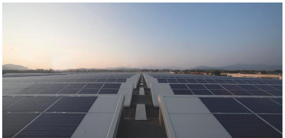
Napelemek a Társaság épületének tetőszerkezetén
